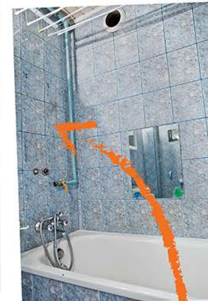
Demontaż starego piecyka gazowego, likwidacja instalacji gazowej i wykonanie otworu do komina spalinowego
